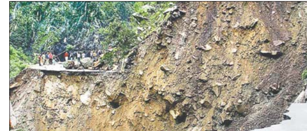
गोविंदघाट में पिन्जोला के पास करीब 20 मीटर तक बहा बदरीनाथ हाईवे।
